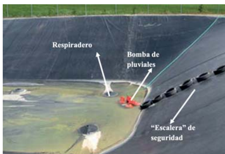
Figura 4.- Fosa de purín cubierta con lámina flotante. El borde de la lámina se asegura enterrándolo en la periferia de la fosa. La escalera de seguridad está hecha con neumáticos pegados a la lona. Cortesía de Navarra Agraria.
